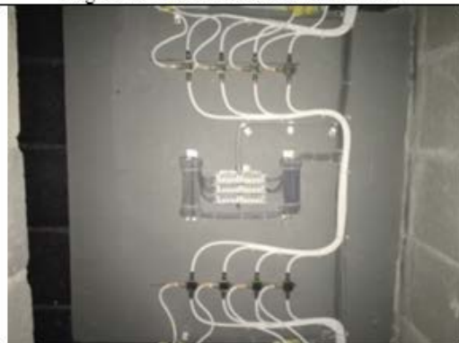
Figura 17 – Vista Cabeamento Telefone / Antena Coletiva
