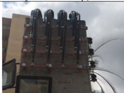
Figura 18 – Vista Entrada de Energia
