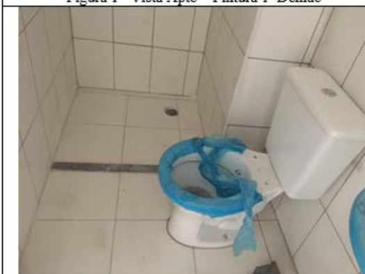
Figura 3–Vista Bacia c/ Caixa Acoplada - Torre B
