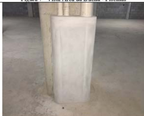
Figura 9– Vista Proteção Tubulação - Garagens
