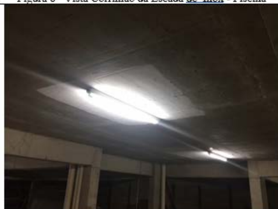
Figura 10– Vista Iluminação - Garagens
