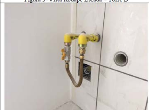
Figura 5- Vista Bv-pass gás dos aptos - Torre A/B
