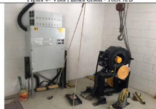
Figura 6- Vista Casa de Máquinas Elevadores - Torre B
