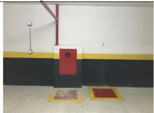
Figura 12- Vista Pintura Garagens - Incêndio
