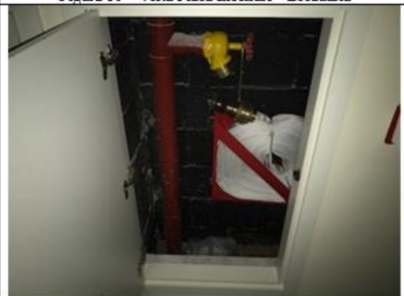
Figura 18 – Vista Hidrantes de Incêndio
