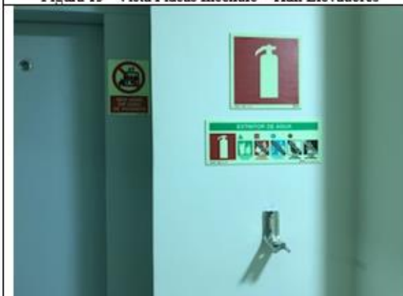
Figura 15 – Vista Placa Incêndio – Extintores - Hall
