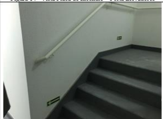
Figura 16 – Vista Placa Incêndio - Escadaria
