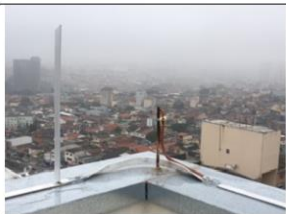
Figura 20– Vista Aterramento Para-raio
