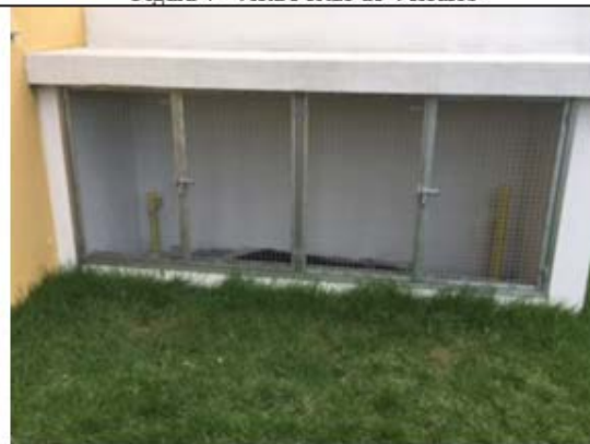
Figura 6– Vista Abrigo Entrada de Gás
